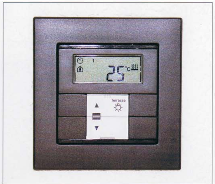
La domotique permet le pilotage de l'ensemble des stores électriques (8 moteurs de stores), un pilotage manuel ou par scénarios, et une position de sécurité et /ou de protection solaire automatique en liaison avec la station météo.
