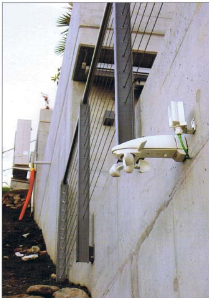
On distingue au premier plan la station météo. Tout en haut à gauche, le compresseur de la pompe à chaleur air-eau réversible de 11.9 kW.
