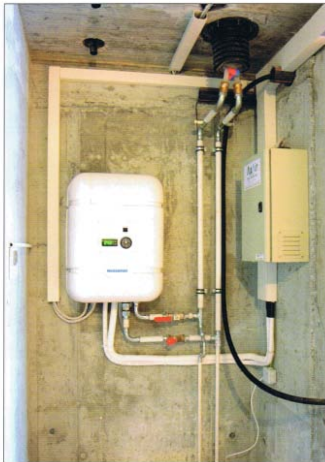
Le module hydraulique de la pompe à chaleur, dans le local technique, permet de transmettre l'énergie thermique dans le circuit d'eau de l'appartement.
