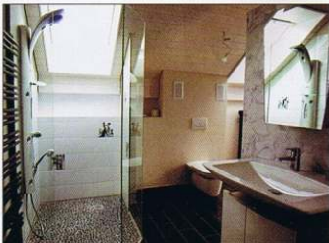
Vue partielle des équipements sanitaires.
